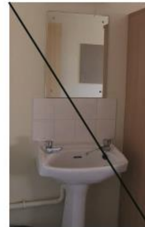
Плохо Раковина с пьедесталом. Фартук из плитки
